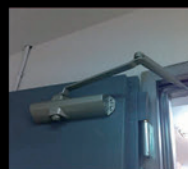
► Cierrapuertas colocado en lado contrario bisagras
